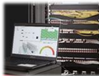
Il software DCIM inteliPhy net di R&M permette ora anche la gestione degli asset dell'hardware IT.
